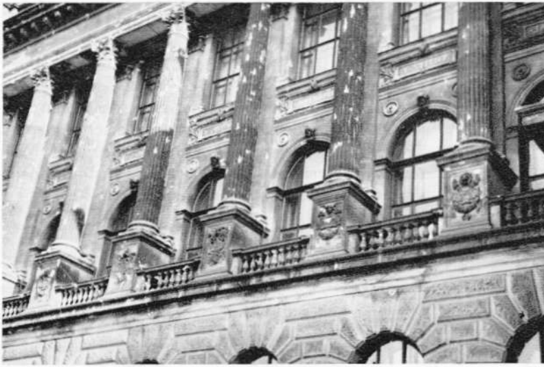
Beim Einmarsch der Truppen des Warschauer Paktes in Prag wurde das Nationalmuseum am Wenzelsplatz stark beschädigt. Die zerschossenen Fensterscheiben mußten binnen weniger Tage neu ersetzt werden, doch die zahlreichen Einschüsse an Säulen und Wänden und im Innern konnten nicht beseitigt werden und erinnern weiterhin an die Gewaltakte der »Brudernationen«.
