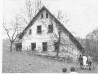
Das 1928 neu erbaute Haus Nr. 68 Steiner Rudolf ist dem Verfall preisgegeben. Keine Fenster, Türen, sogar der Fuß- boden fehlt.
