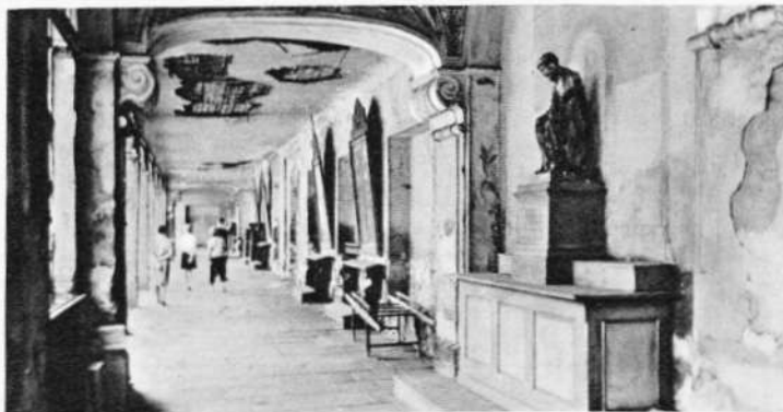
Der Kreuzgang der Wallfahrtskirche. Von der Decke fällt der Putz. Die schönen und wertvollen Kreuzgangsbilder sind stark verwittert und dem Verfall preisgegeben.
